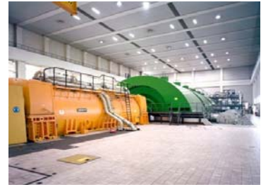
Bildquelle: EON Kernkraft GmbH
